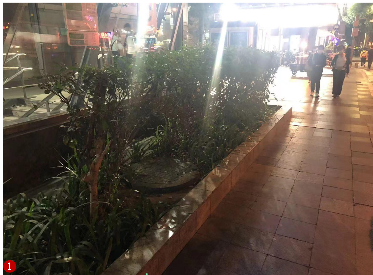
现场设备井盖暴露，影响环境美观。
